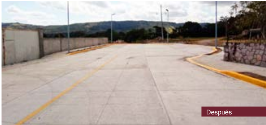
Construcción de pavimento hidráulico en calle Chico Domínguez, prolongación 5 de Mayo y calles a la Unidad Deportiva* Localidad de Actopan, municipio de Actopan
