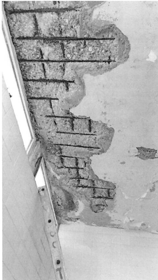
TECHO DEL BAÑO
