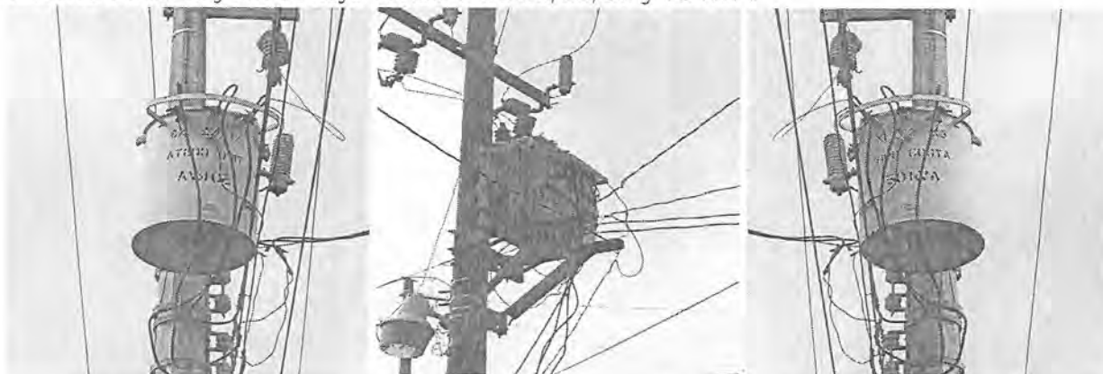
Figura 3: Transformadores con los que cuenta el municipio de Tampico Alto, Ver.
