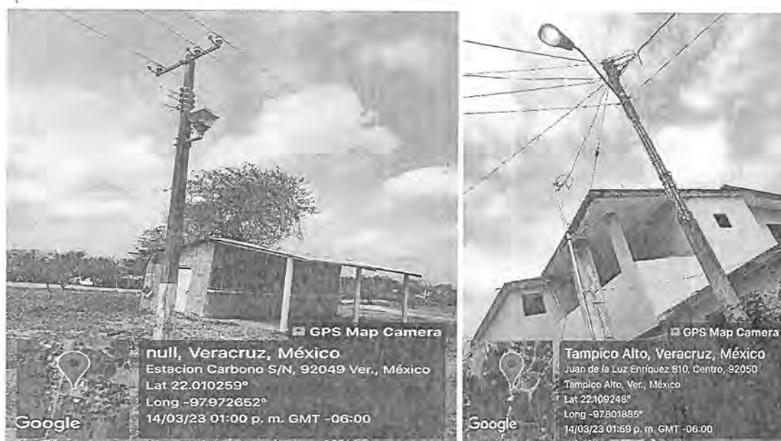
Figura 2: Condición actual de las luminarias municipales de Tampico Alto.
